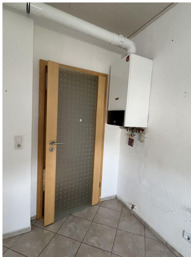
Eigene Gas-Therme 1.OG
