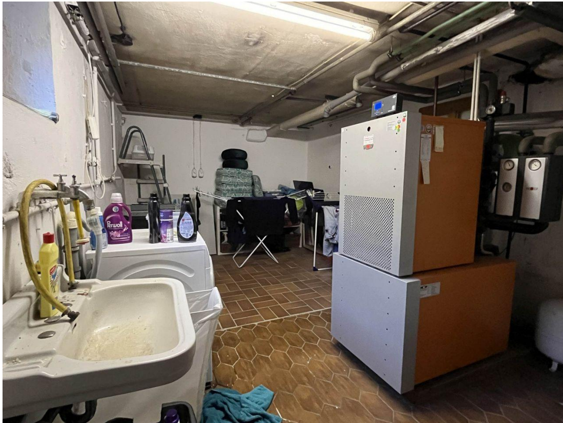
Waschlüche und Heizung
