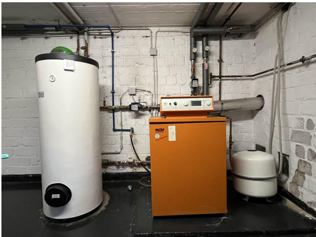
Gas-Zentralheizung im KG
